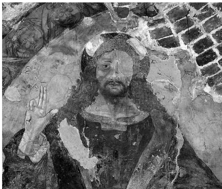
Fig. 13. Pitture murali del catino absidale. Particolare del volto del Cristo Pantocratore con evidenziazione delle numerose lacune del film pittorico e delle integrazioni pittoriche eseguite nel corso degli ultimi interventi di restauro.
