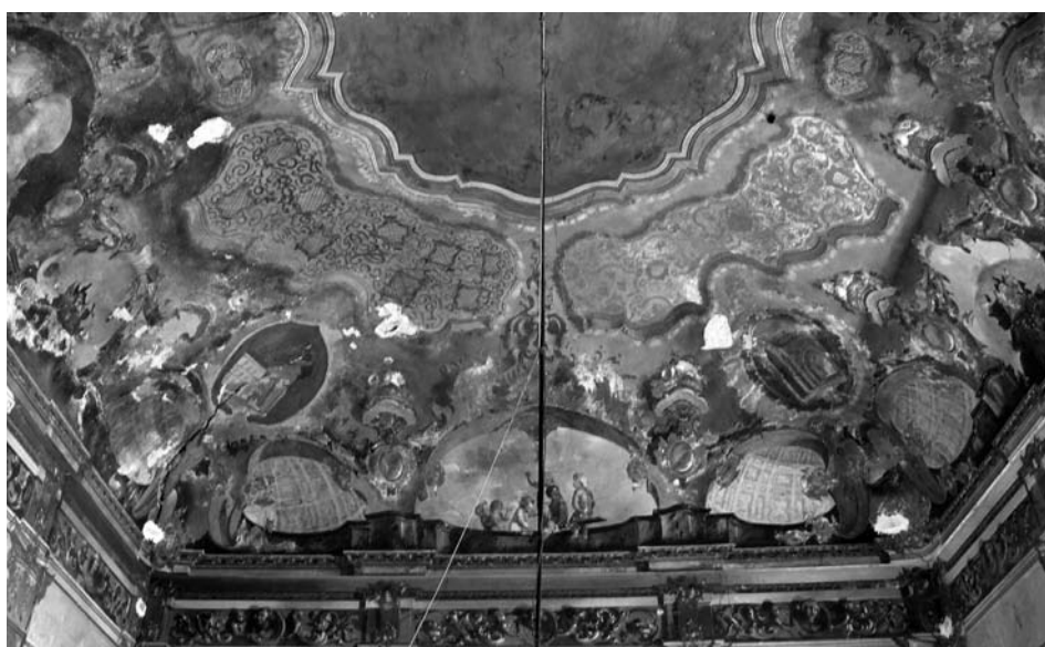
Fig. 15. Salone del piano nobile. Particolare della decorazione pittorica della volta con evidenziazione di parti della decorazione integralmente ridipinte.
