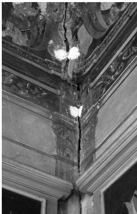
Fig. 13. Salone del piano nobile. Particolare della decorazione pittorica della volta con evidenziazione delle preoccupanti lesioni visibili in corrispondenza dei punti angolari.
